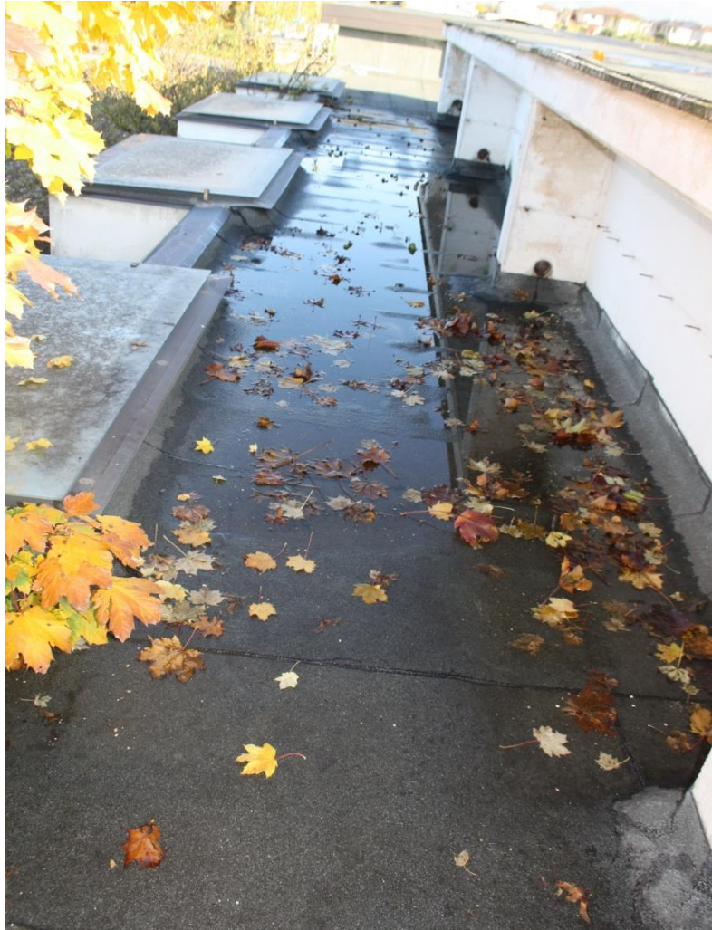
“A” Copertura ovest – Ristagni
