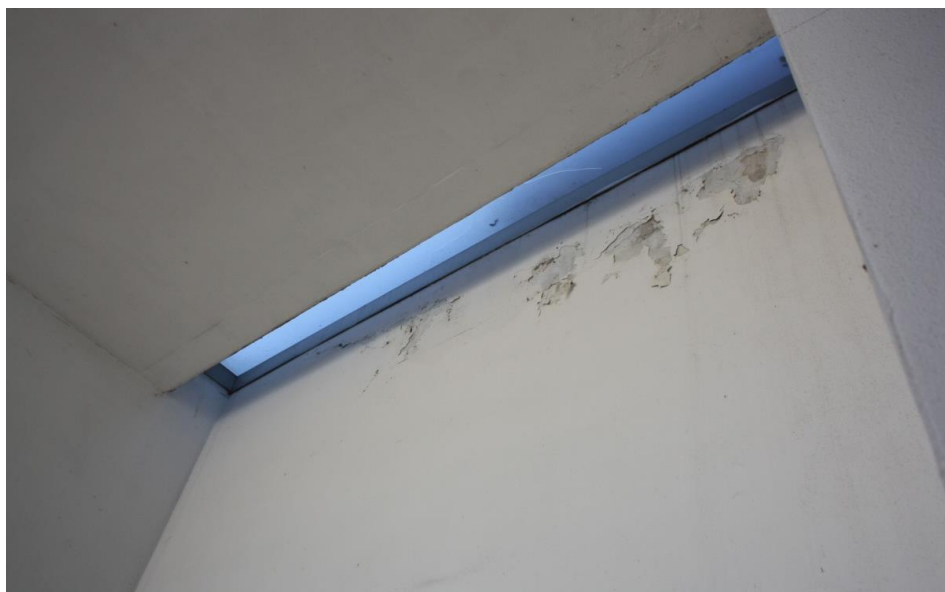
“A” piano terra Sud – Intonaco ammalorato da infiltrazioni
