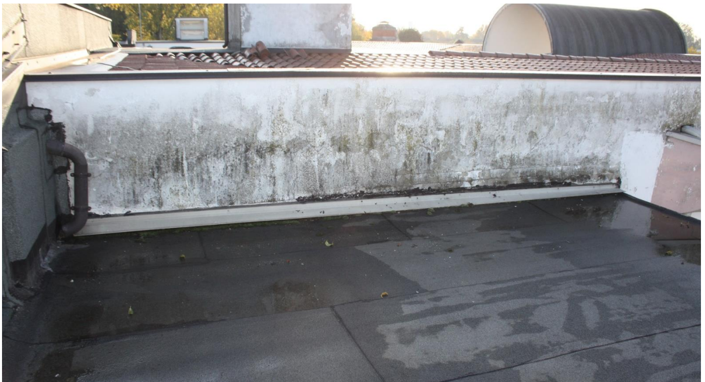
“A” Copertura Nord – Distacco intonaco
