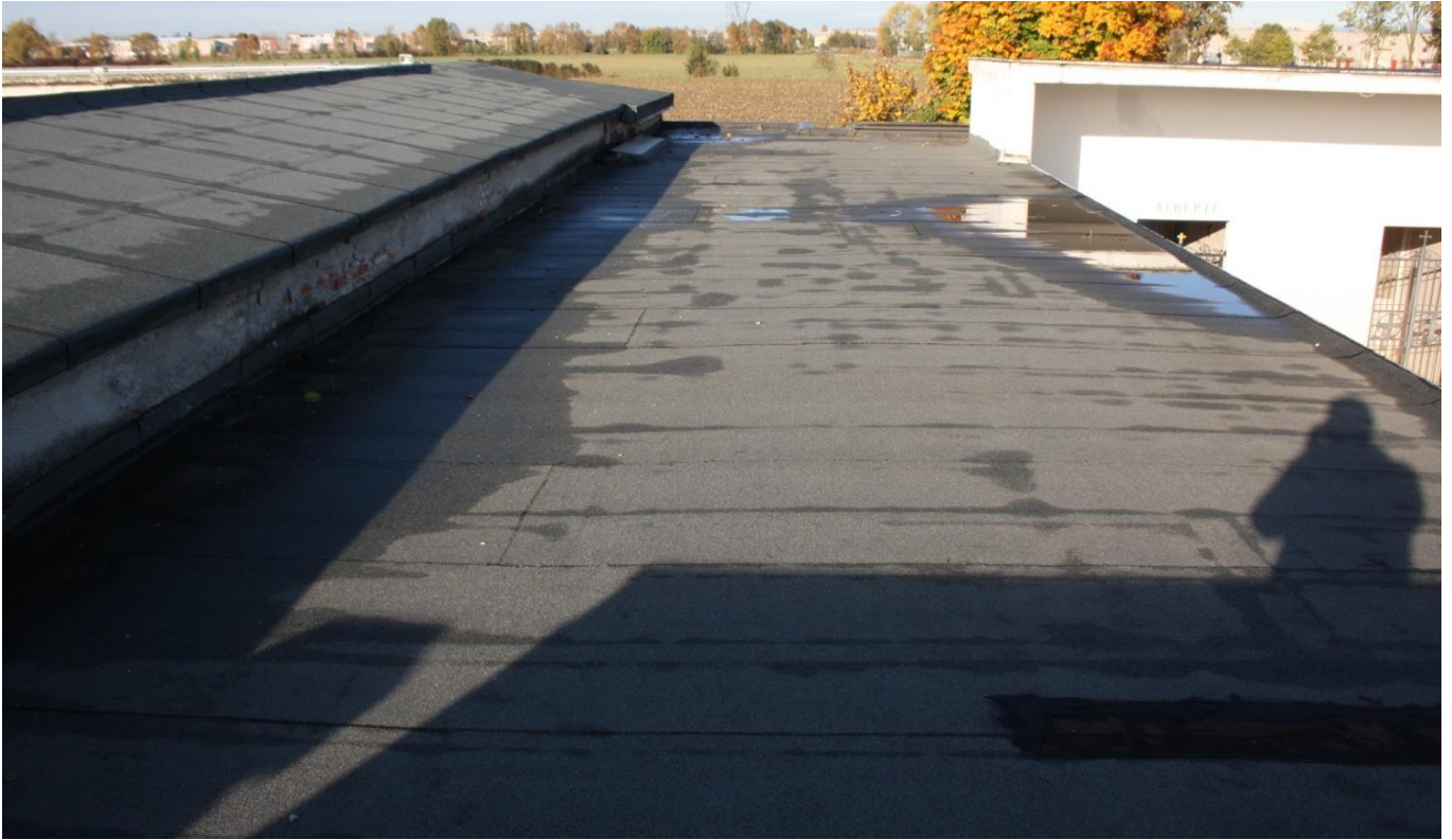
“A” Copertura sud – Ristagni
