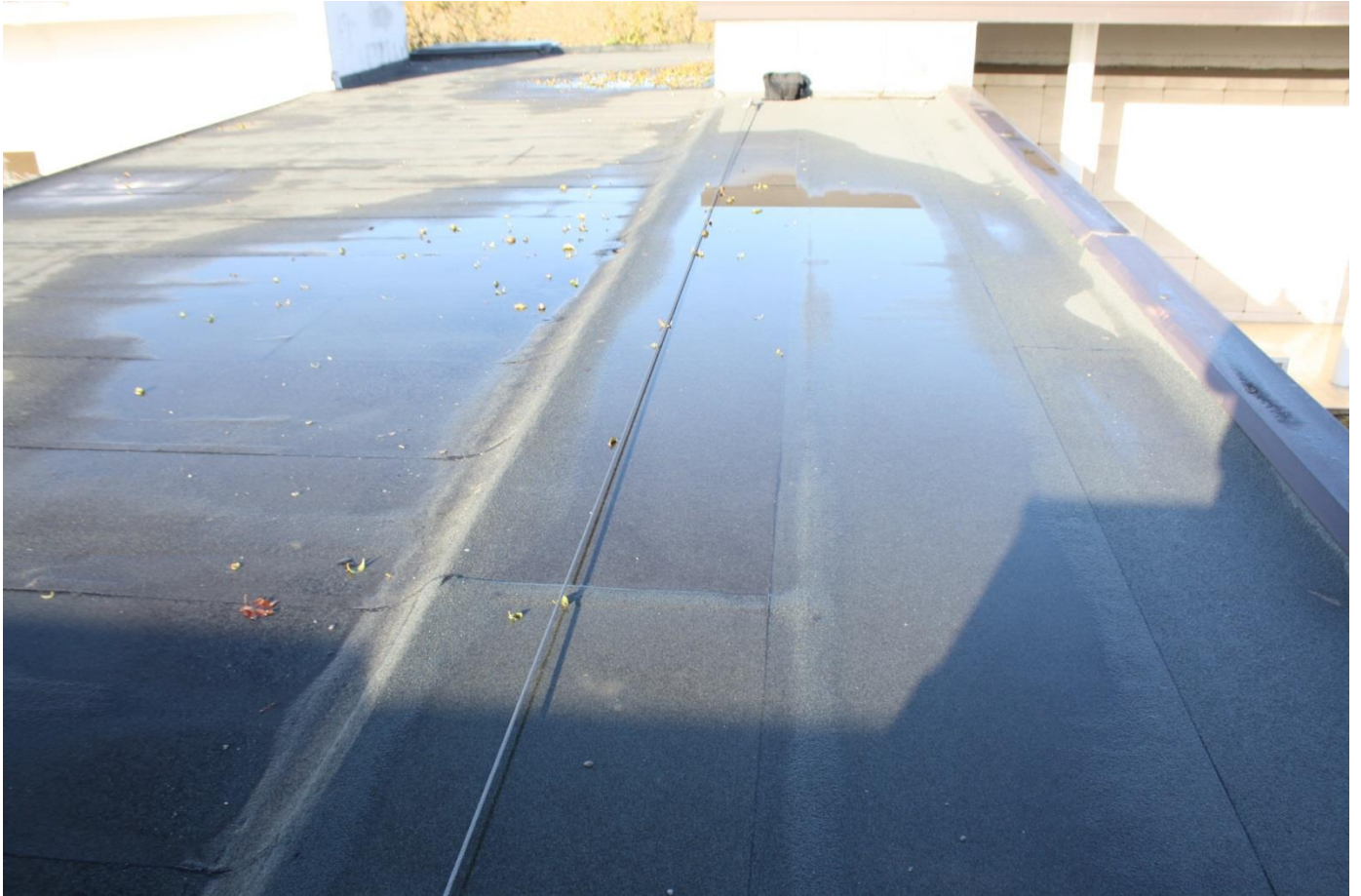
“A” Copertura Nord – Ristagni
