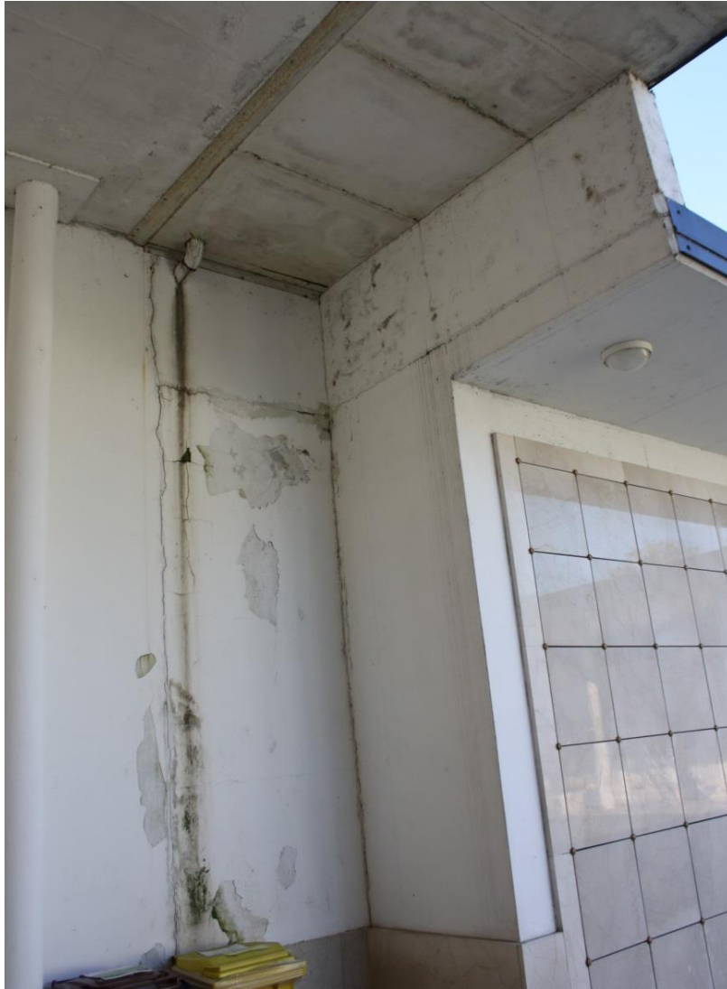
“A” piano terra Nord sotto blocco pluviale nord-est – Intonaco ammalorato da infiltrazioni
