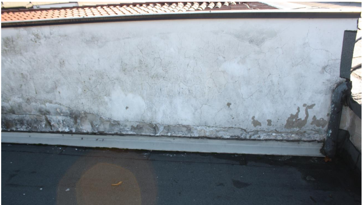
“A” Copertura sud – Distacco intonaco
