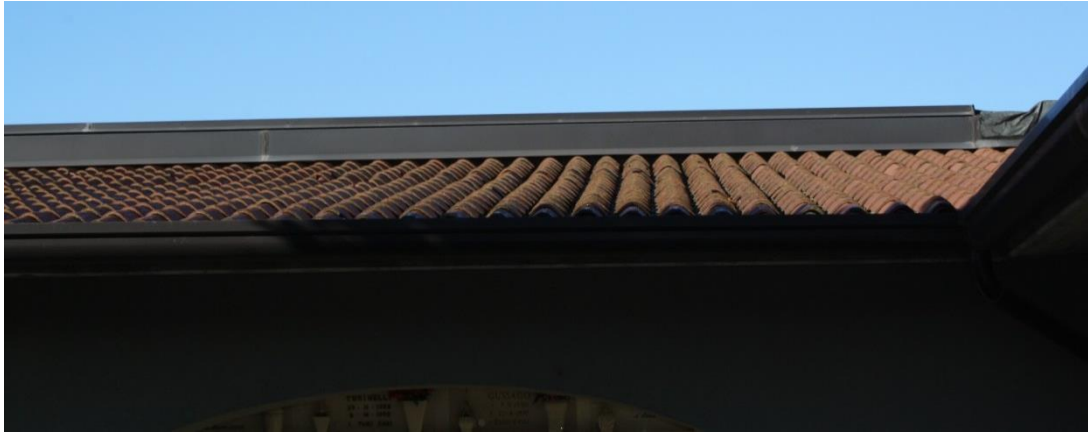
“B” Altro Corpo di Fabbrica a Est – Danni al manto di copertura
