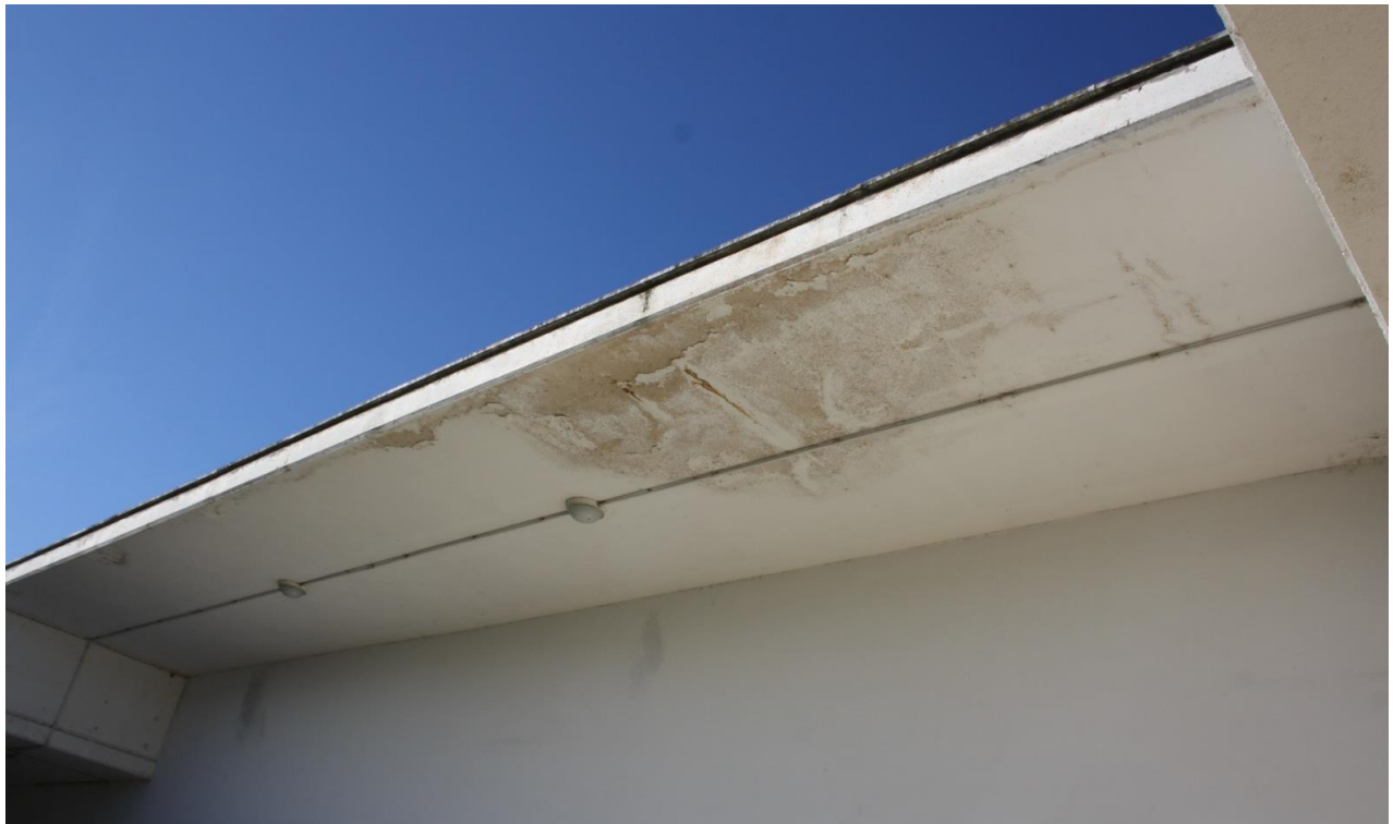
“A” piano terra – Intonaco ammalorato da infiltrazioni
