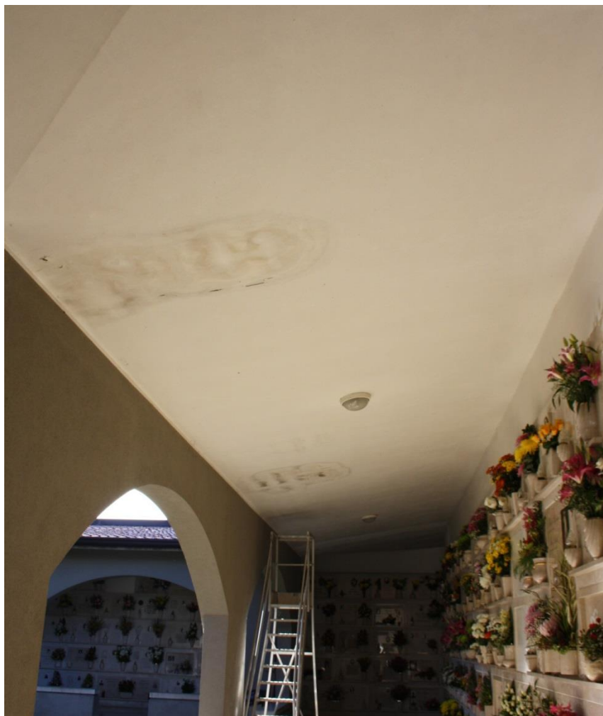
“B” Altro Corpo di Fabbrica a Est – Infiltrazioni per danni al manto di copertura
