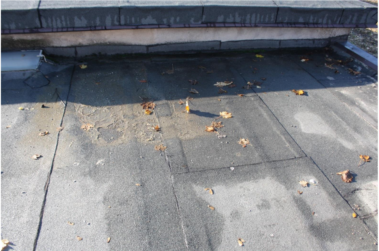
“A” Copertura sud – Ristagni
