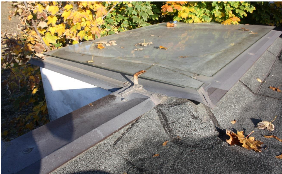
“A” Copertura ovest – Vetro danneggiato
