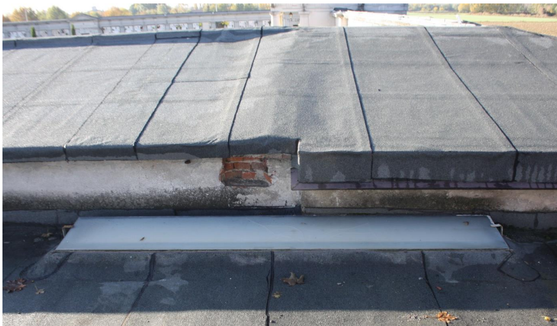
“A” Copertura sud – Vetro danneggiato
