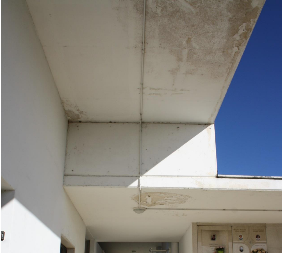
“A” piano terra – Intonaco ammalorato da infiltrazioni
