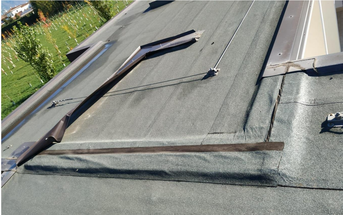
“C” Altro Corpo di Fabbrica a Nord – Scossalina divelta da temporale
